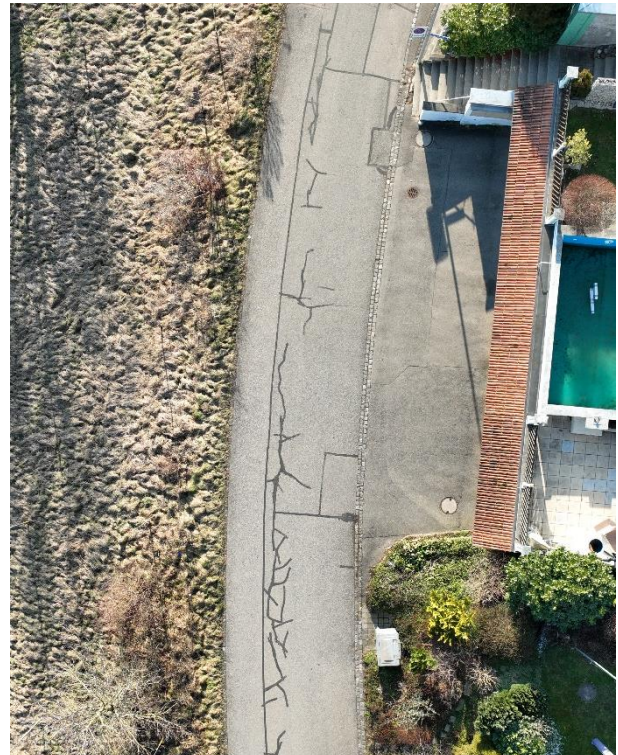
Abbildung 7: Allgemeinzustand (Bild Ingesa AG)
